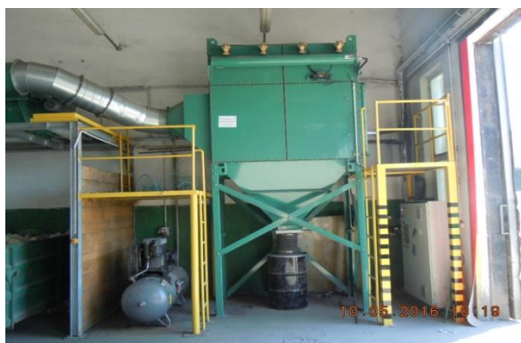
Rysunek 30 Tak jest. Sortownia odpadów komunalnych zmieszanych i selektywnie zebranych – separator powietrzny, Puszczka Miejska (foto. Puszczka Miejska, październik 2015r.)
