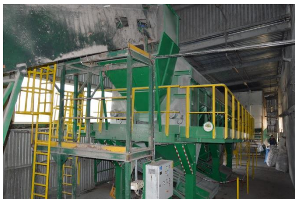
Rysunek 28 Tak jest. Sortownia odpadów komunalnych zmieszanych i selektywnie zebranych - sito bębnowe, Puszczka Miejska (foto. Puszczka Miejska, październik 2015r.)
