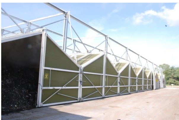
Rysunek 72 Tak było i jest. Instalacja stabilizacji frakcji biodegradowalnej wydzielonej ze zmieszanych odpadów komunalnych, Toruń MPO (sierpień 2013r)
