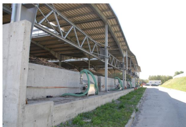
Rysunek 77 Tak było i jest. Instalacja do stabilizacji biologicznej odpadów – proces suszenia, Wawrzynki (sierpień 2013r)
