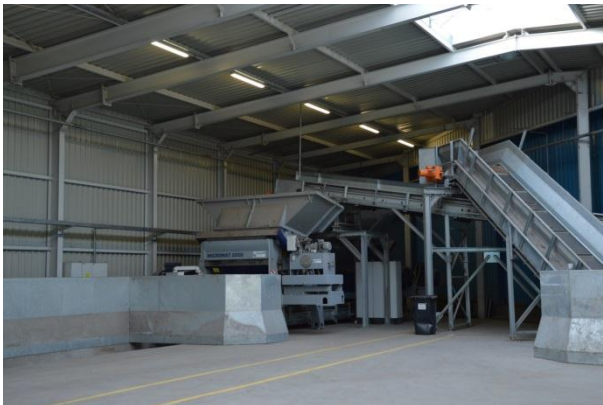
Rysunek 84 Tak jest. Instalacja produkcji paliwa alternatywnego – układ podawania i rozrywania, Inowrocław (fot: Inowrocław. Wrzesień 2015r)
