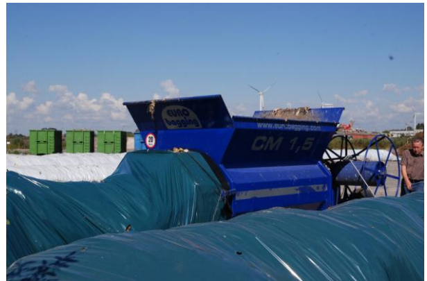
Rysunek 85 Tak było. Instalacja stabilizacji frakcji biodegradowalnej wydzielonej ze zmieszanych odpadów komunalnych- system rękawów foliowych, Inowrocław (sierpień 2013r)
