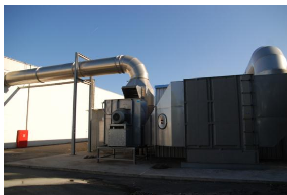
Rysunek 54 Tak było i jest. Instalacja stabilizacji frakcji biodegradowalnej wydzielonej ze zmieszanych odpadów komunalnych- system wentylacji, Remondis Bydgoszcz (sierpień 2013r)
