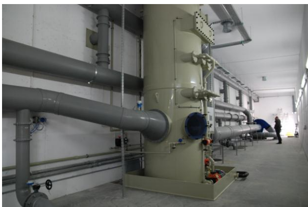
Rysunek 45 Tak było i jest. Instalacja stabilizacji frakcji biodegradowalnej wydzielonej ze zmieszanych odpadów komunalnych- system wentylacji, CORIMP Bydgoszcz (sierpień 2013r)
