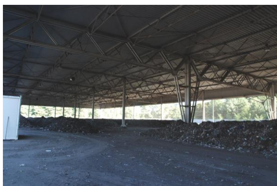
Rysunek 53 Tak było. Instalacja stabilizacji frakcji biodegradowalnej wydzielonej ze zmieszanych odpadów komunalnych- plac przyzwoity zadaszony Remondis Bydgoszcz (sierpień 2013r)
