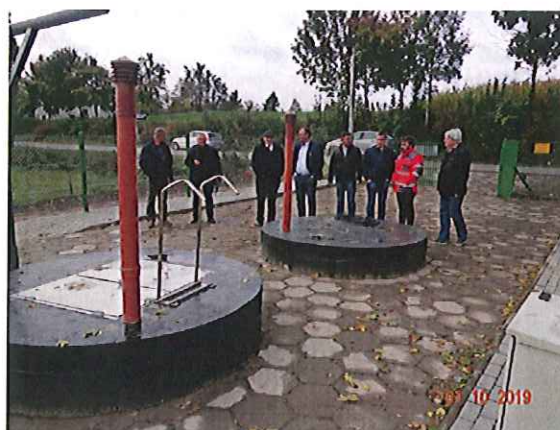
Przepompownia ścieków w Mszanie po modernizacji
